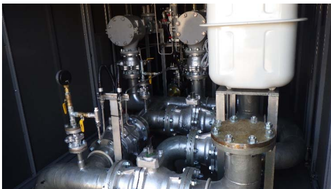
ガバナユニット配管(2020.12.26)
