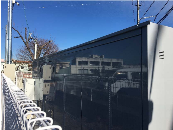
遠隔監視装置及び監視カメラ(2020.12.16)
