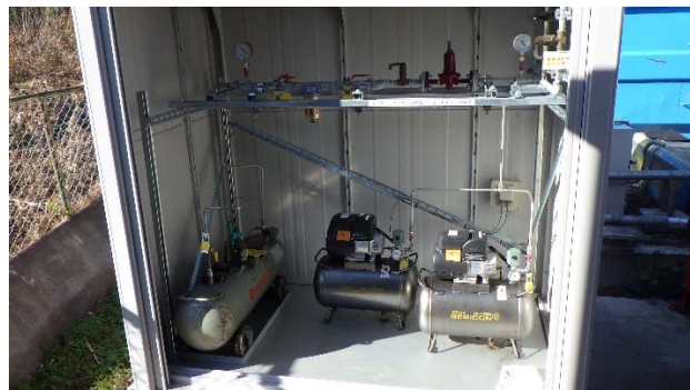
計装エア-配管(2020.08.28)
