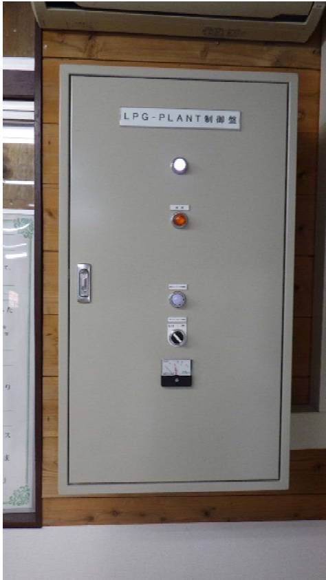
プラント制御盤(2020.04.01)
