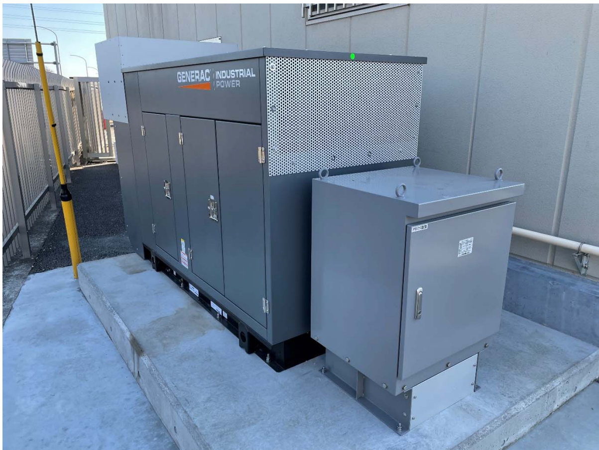
非常用発電機(2020.12.08)
